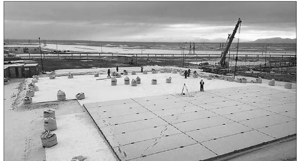
↑ На строительной площадке подрядчик произвёл отсыпку, трамбовку основания, а затем – утепление фундамента и укладку железобетонных плит. Следующий этап – монтаж металлоконструкций. ФОТО: ООО «ПРОФСТРОЙ»
