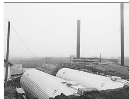
↑ Резервуары с водой необходимы для стабильной работы всей системы жизнеобеспечения Лорино, где проживает около 950 человек.
